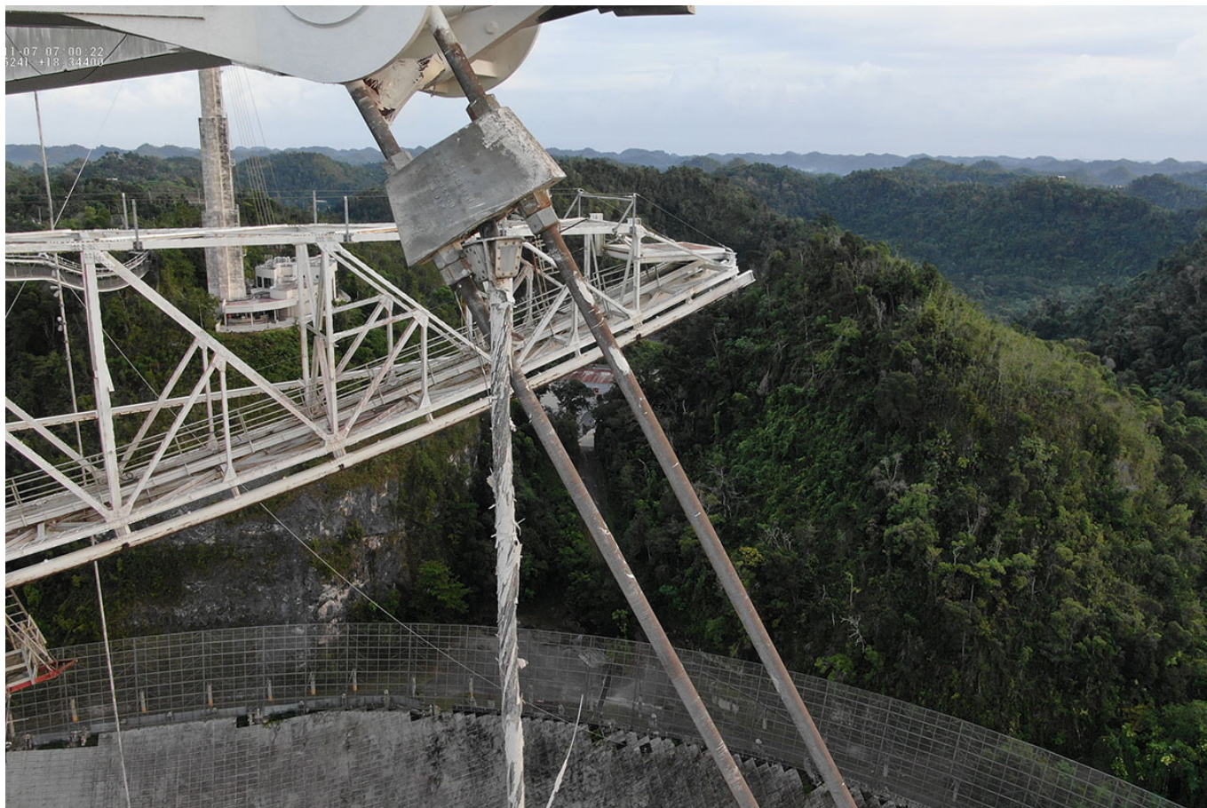
Uszkodzona stalowa lina podtrzymująca konstrukcję radioteleskopu Arecibo - obraz z pokładu drona. Fot. NAIC - Arecibo Observatory/NSF
